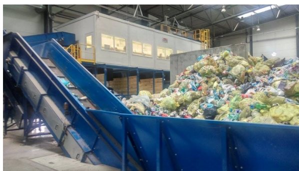
Fot. 6.1. Regionalna Instalacja do Przetwarzania Odpadów Komunalnych w Sulnowku – część mechaniczna MBP.
